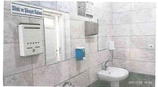
wc el yıkama alanı.jpg
